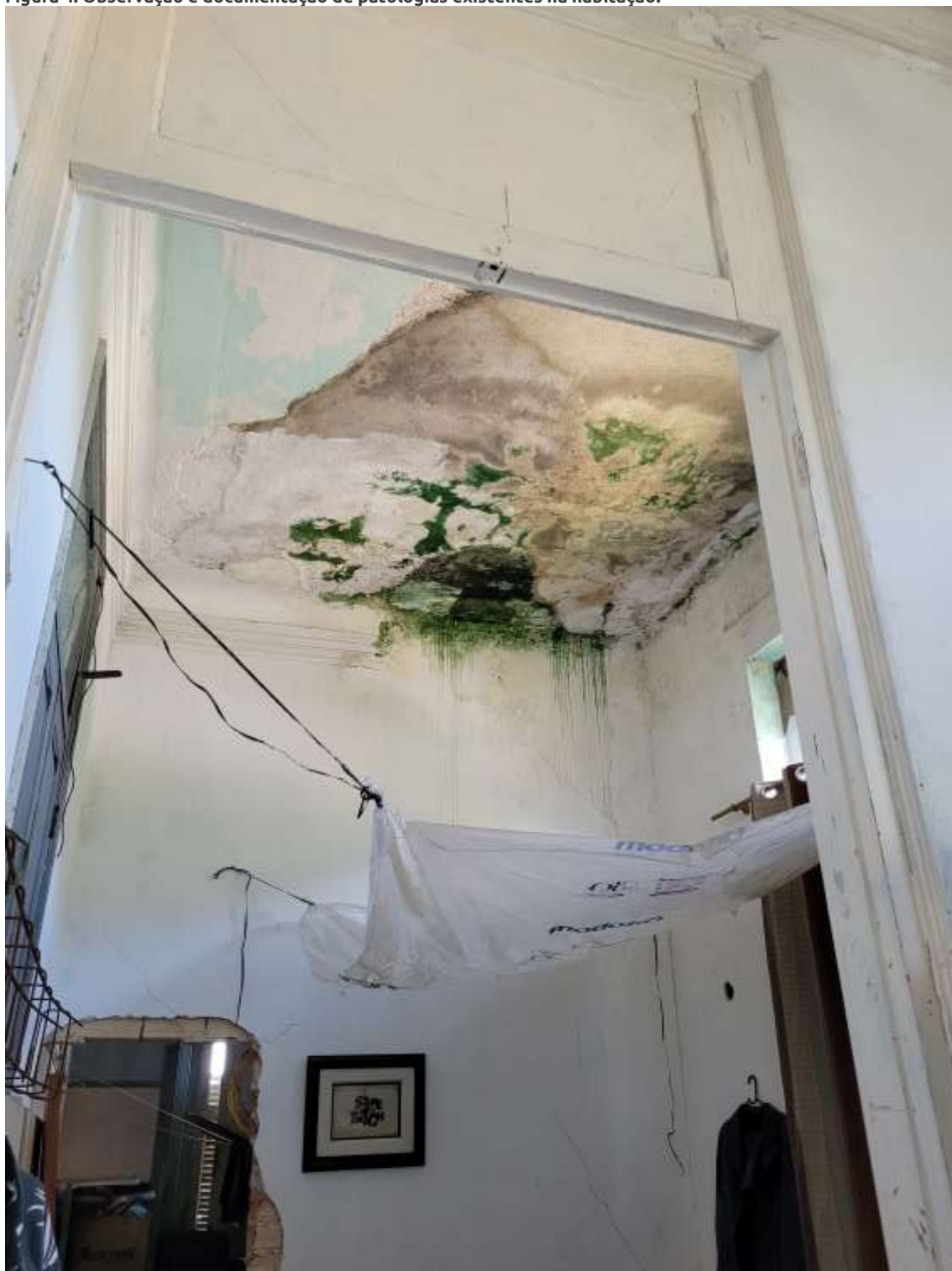
Figura 4: Observação e documentação de patologias existentes na habitação.
