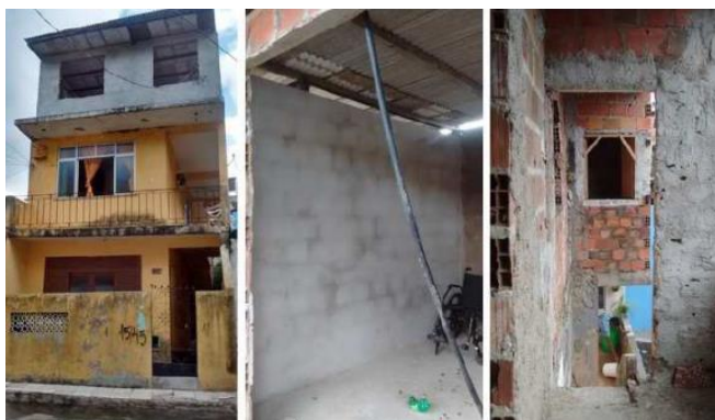
Figura 18: Obras não concluídas no município de Salvador – Programa Morar Melhor.
