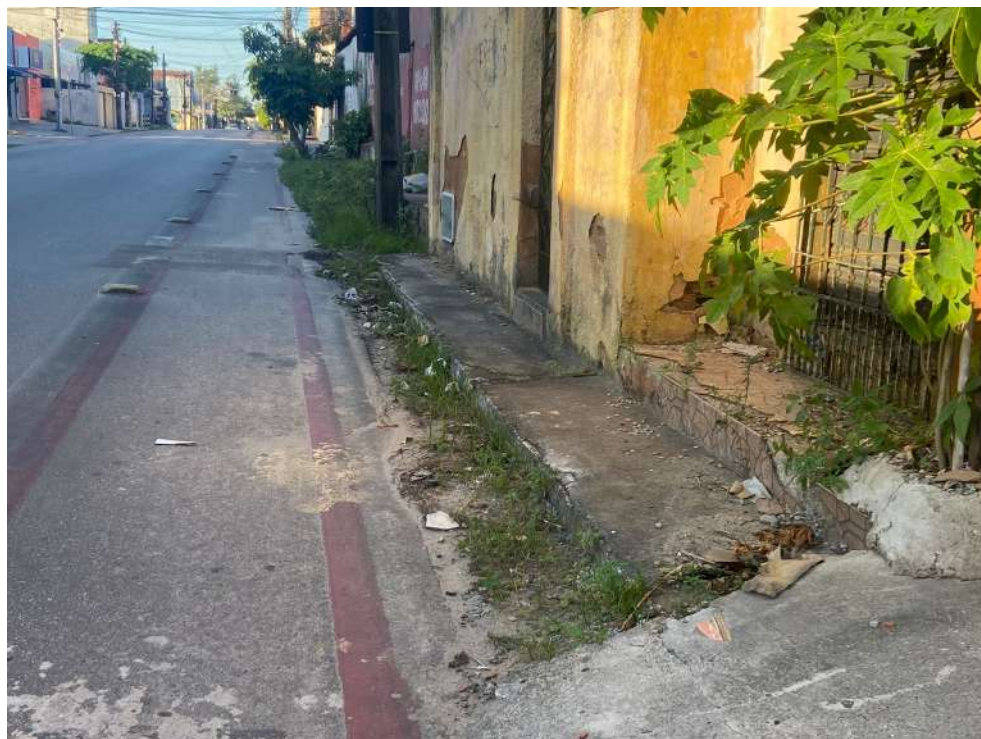
Figura 15 - Calçada quebrada e estreita na Rua Alberto Magno
